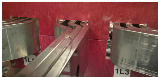
Rys. 8. Termopara umieszczona na środkowej fazie przyłącza klienta
